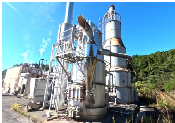
木質バイオマスボイラー
